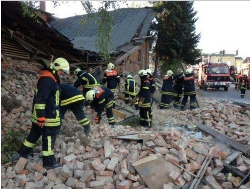
Teile des Mauerwerks liegen auf der Geniner Straße. Hier ist kein Durchkommen mehr. © Ulf-Kersten Neelsen
